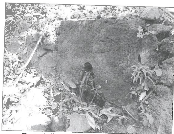
Figure 4 : l'extrémité du trop plein / vidange
