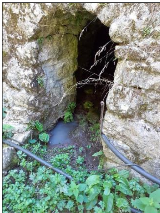
Rejet d'eaux vannes et ménagères brutes vers un ruisseau
