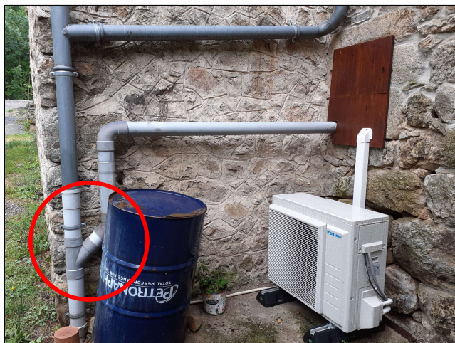
Rejet des eaux usées partiellement traitées directement dans une gouttière ayant pour exutoire un cours d'eau Défaut de sécurité sanitaire présentant un danger pour la santé des personnes (contact direct possible avec des eaux usées partiellement traitées) et risque de pollution avéré.
